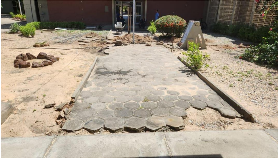
Figura 22 – Melhorias de iluminação e acesso (antes)
