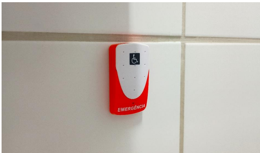
Figura 12 - Botoeira de emergência em banheiro PCD
