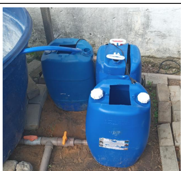
Figura 55: Filtros incluídos no sistema
