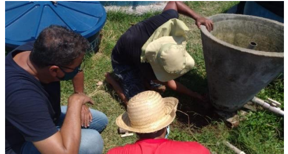
Figura 36: Conserto de um dos decantadores
