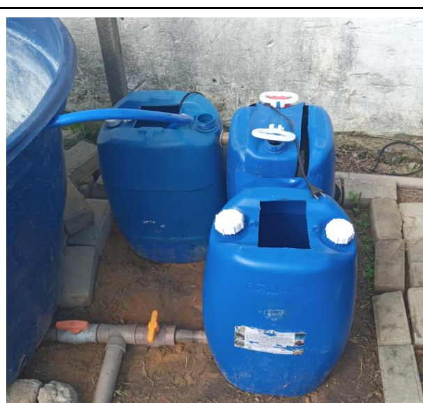
Figura 55: Filtros incluídos no sistema
