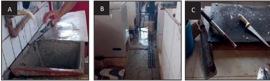
Figura 6 - Estrutura dos boxes comercializadores de pescado em mercados públicos de Parnaíba/PI. A- Sujidades nas estruturas. B- Piso com acúmulo de água. C- Utensílios com focos de ferrugem e sujidades.
