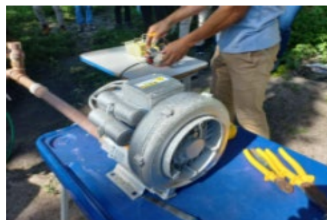
Figura 7. Pannel elétrico e sopradores de ar
